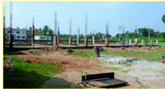
Hinter dem Wohnheim der Jungen, von dessen Dach aus diese Aufnahme entstand, wurde mit dem Bau der neuen Schule begonnen.
