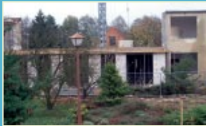
»Haus Friede« am 7. November. Gut zu erkennen: Das herausgenommene Drittel. Hier wird gerade der Fußboden für den Andachtsraum gegossen.
