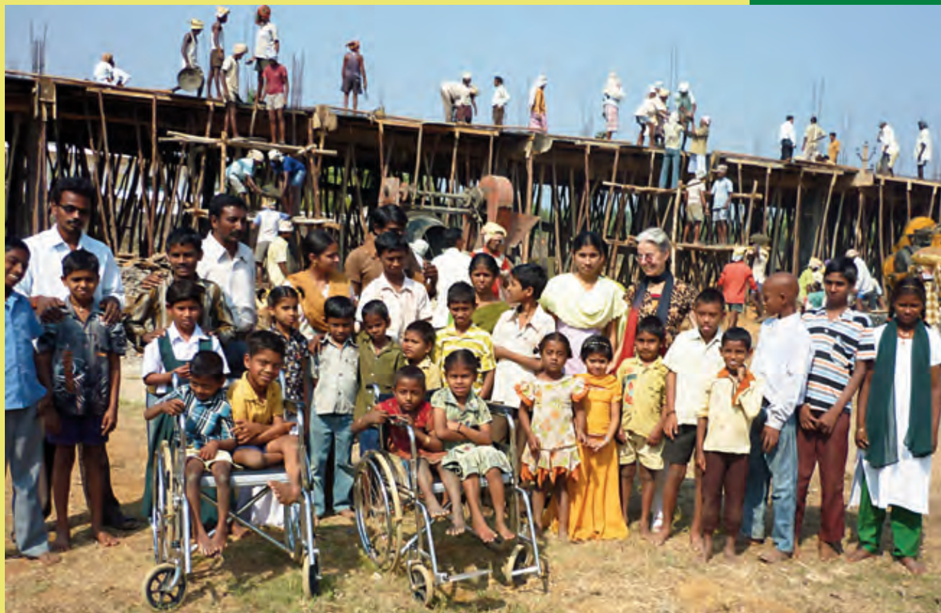
Sr. Beate mit Kindern und Mitarbeitenden vor der Baustelle der neuen Sonderschule
